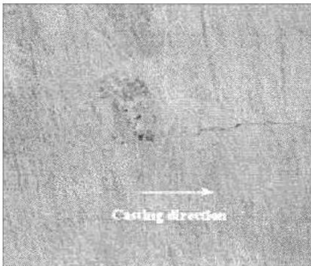
Рисунок А.80 — Трещина в слитке
