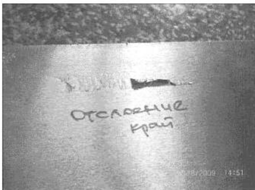
Рисунок А.65 — Отслоение
