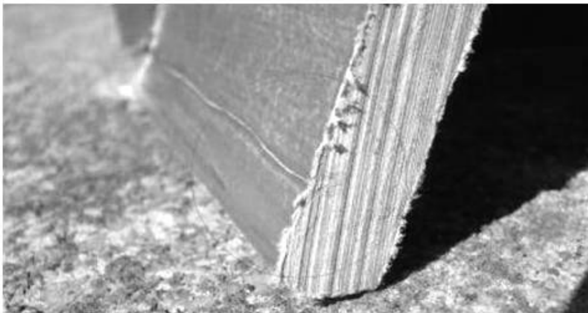
Рисунок А.7 — Волосая трещина
