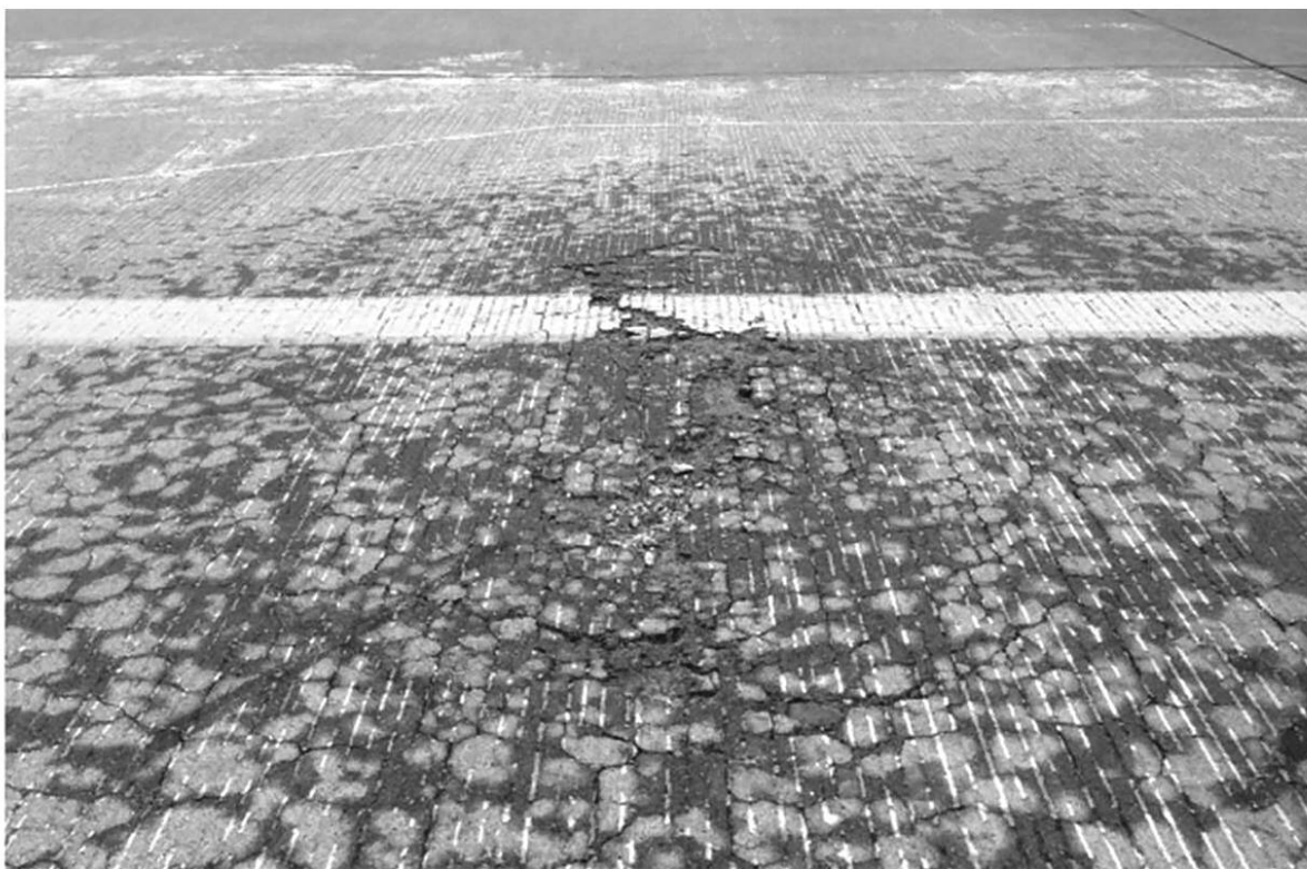
Рисунок 4 — Сетка трещин с выкрашиванием цементного камня и заполнителя
