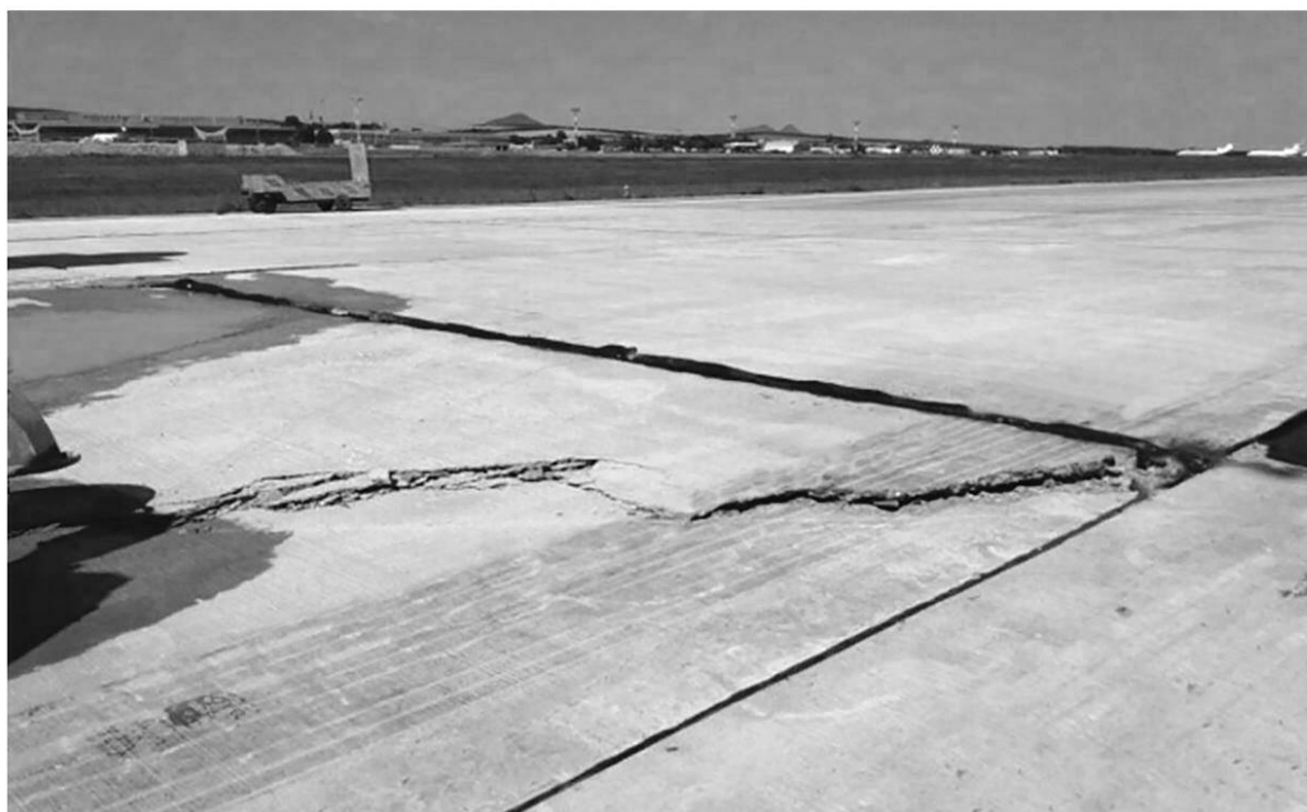
Рисунок 3 — Откол угла плиты в результате температурного перенапряжения
