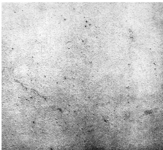
Рисунок 9 — Коррозия металла балл K1 (или Ri 1)
