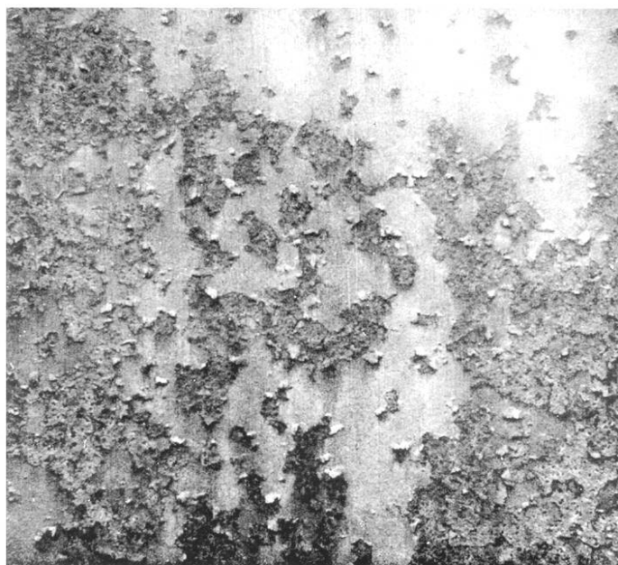
Рисунок 13 — Коррозия металла балл K5 (или Ri 5)
